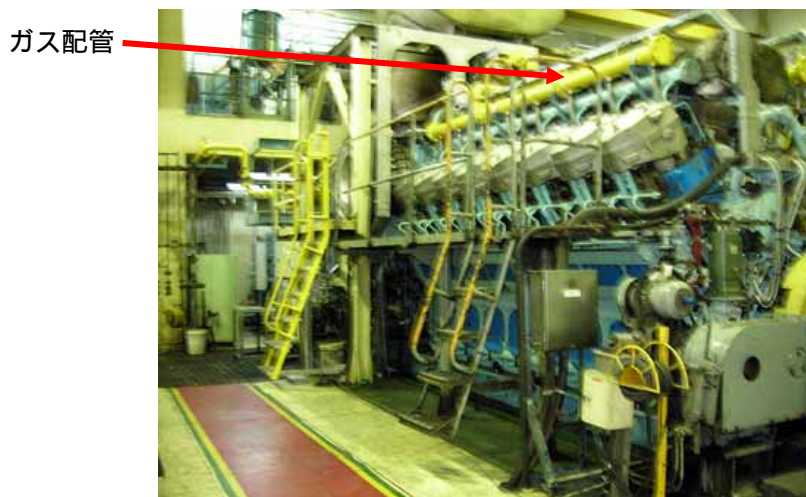
ガス化改造エンジン
